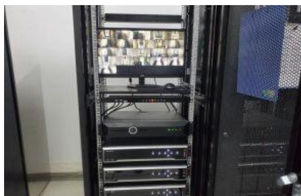
图 2.6-4 监控中心机柜（来源：信息中心）
