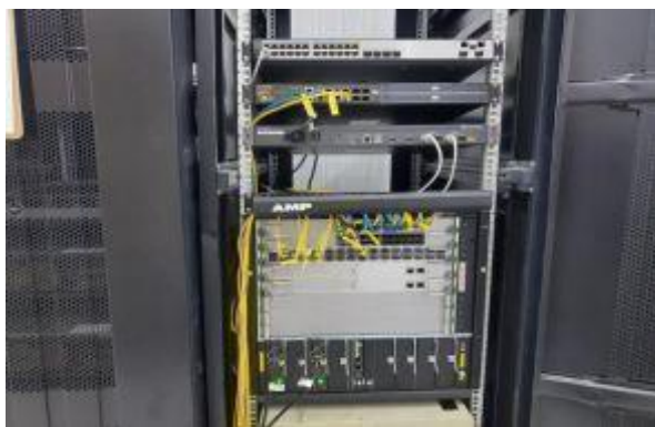
图 2.6-2 中心机房机柜（来源：信息中心）
